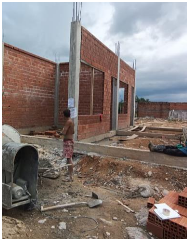
Construccion sin autorizacion
